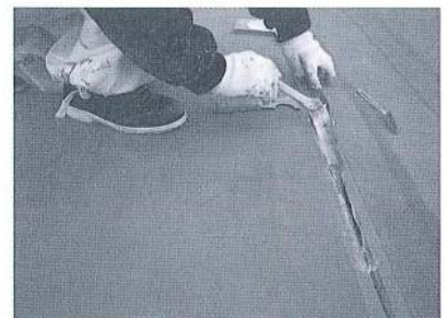
剥がれている部分をよく清掃したうえでゴムエースを塗布する
